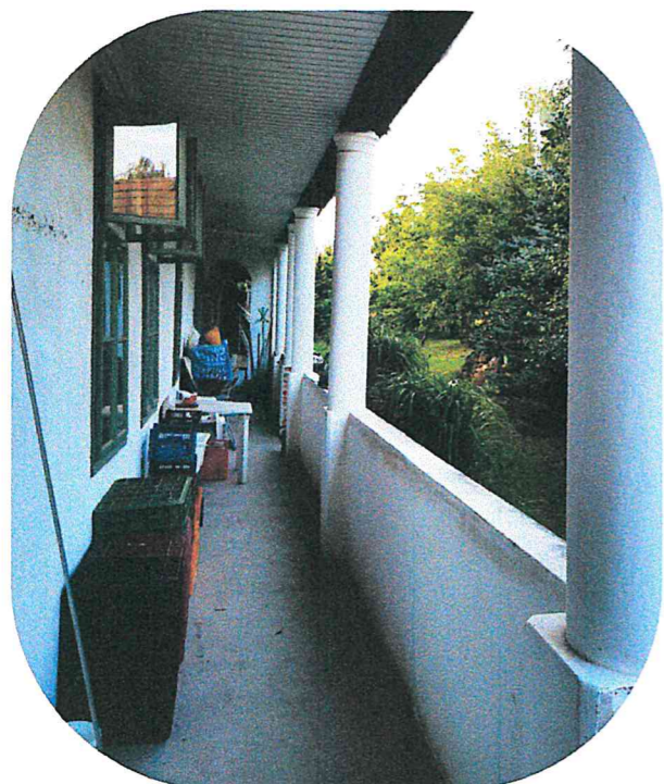
AZ ÉPÜLET EGYIK FONTOS JELLEGZETESSÉGE A TORNÁC. ENNEK A MEGŐRZÉSE MIATT A VÍZELVEZETÉS JAVÍTÁSA MINDENKÉPP SZÜKSÉGES, JELEN PILLANATBAN AZ ESŐVÍZ A HOMLOKZATI FALAKAT KÁROSÍTJA
