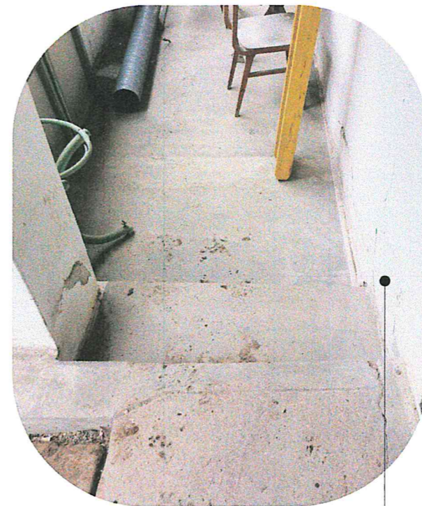
AZ ESŐVÍZ ELVEZETÉSE SZÜKSÉGES A JELLEGZETES TORNÁC MEGTARTÁSÁHOZ
