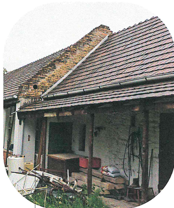
ÉPÜLETRÉSZEK CSATLAKOZÁSÁNÁL A VÍZELVEZETÉS ELEMEI CSERÉRE SZORULNAK, MELY JELEN PILLANATBAN FOLYAMATOSAN ROMLÓ ÁLLAPOTBAN VAN
