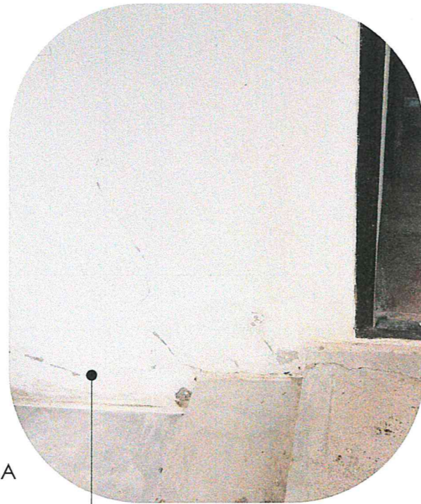
A TORNÁCRA BEJUTÓ ESŐVÍZ SÚLYOS KÁROKAT OKOZ A MEGLÉVŐ ÉPÜLETEN
