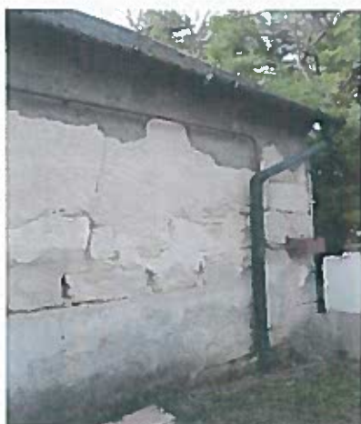
5. kép. Leázott hosszfőfal szomszéd felől alig 2 m-es ereszcsatornával
