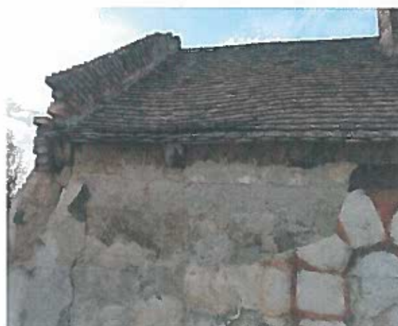
6. kép. Párfödém gerendavégei ereszcsatorna nélkül, leomlott vakolattal
