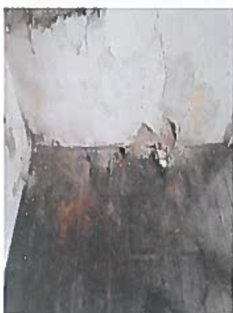
45. kép. Beszakadt gombabontott hajópadló
