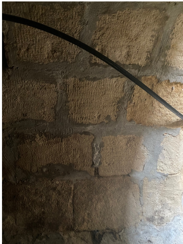
A durvamészkből kialakított pince boltozat egységes, színvonalasan faragott elemekből készült, az igénytelen cementes fugázás későbbi, nem építéskori.
