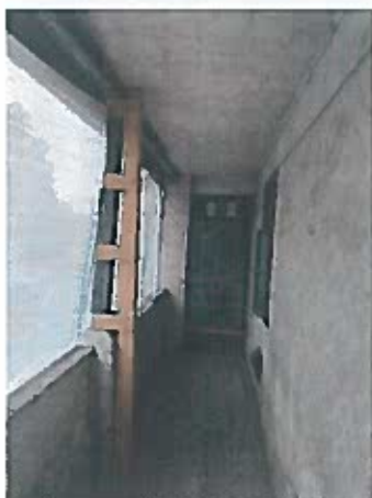
43. kép. Veranda oszlop kibillenés elleni megfogása
