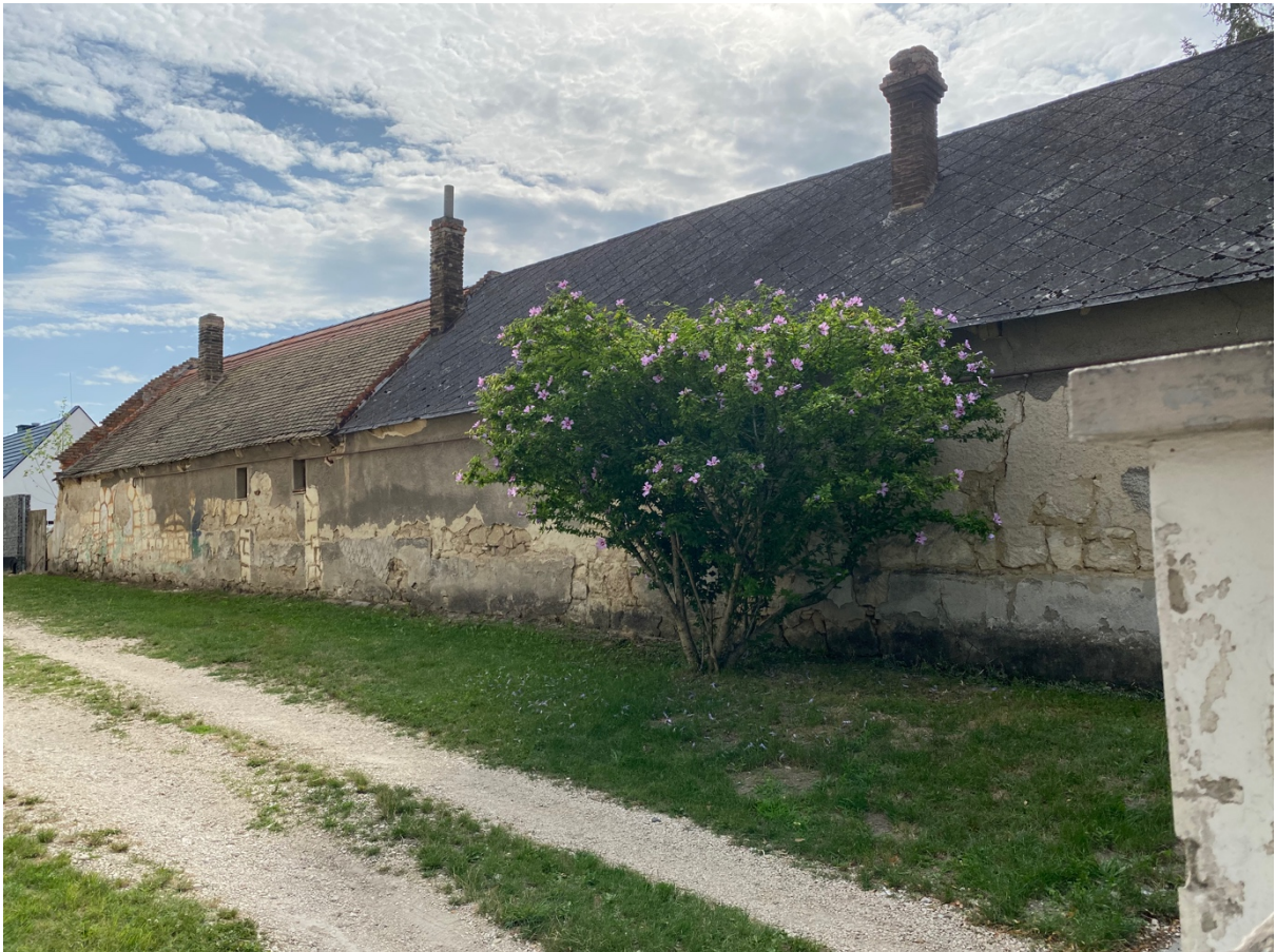
Az épület hátoldalán a templomkert felől a vakolat az ereszcsonna hiánya miatt pusztult le.
