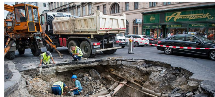
Beszakadt az úttest a Ferenciek terénél
