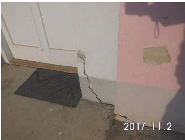
A nem megfelelően elvezetett csapadékvíz az épület süllyedéséhez vezetett.
