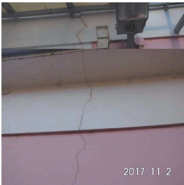
Az épület falazatán szerkezeti repedések vannak.
