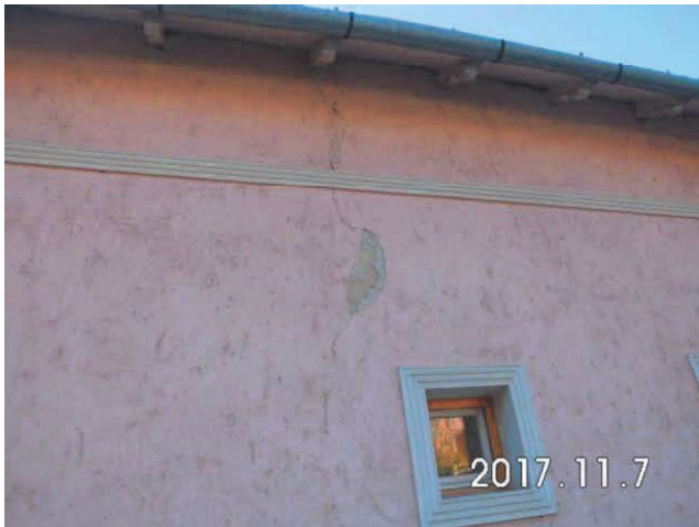
Az épület falazatán szerkezeti repedések találhatóak.
